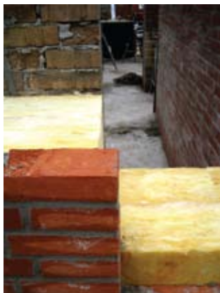
Fra byggeprocessen. Her ses, hvordan formuren er forskudt fra bagmuren i stedet for en traditionel murfals.
